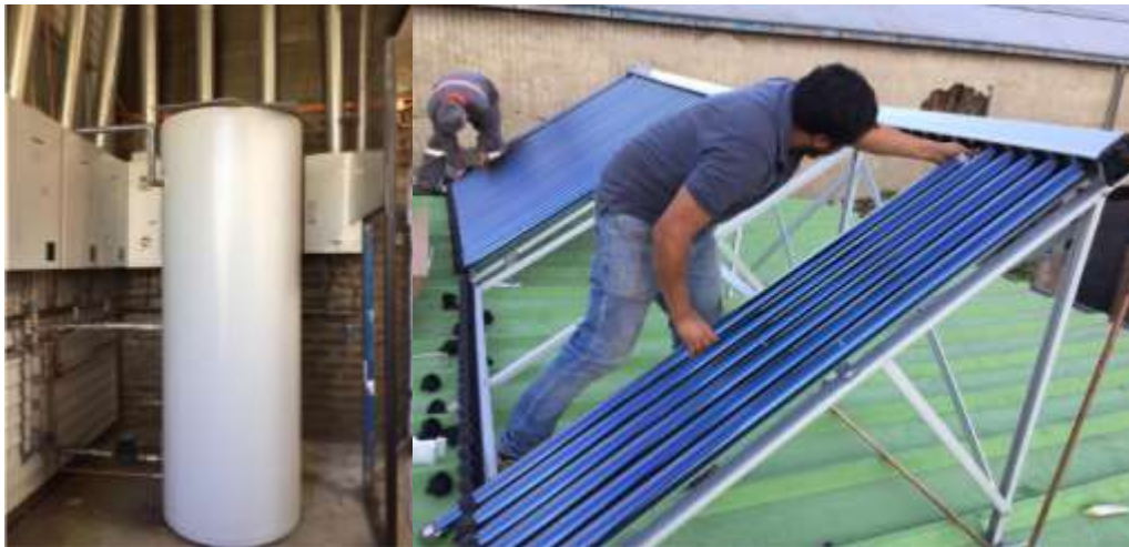
Incorporación equipos de eficiencia hídrica y energética
