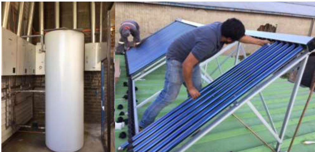
Incorporación equipos de eficiencia hídrica y energética
